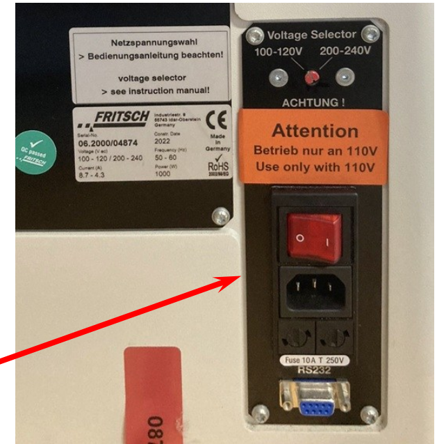
【電源切換部拡大】
