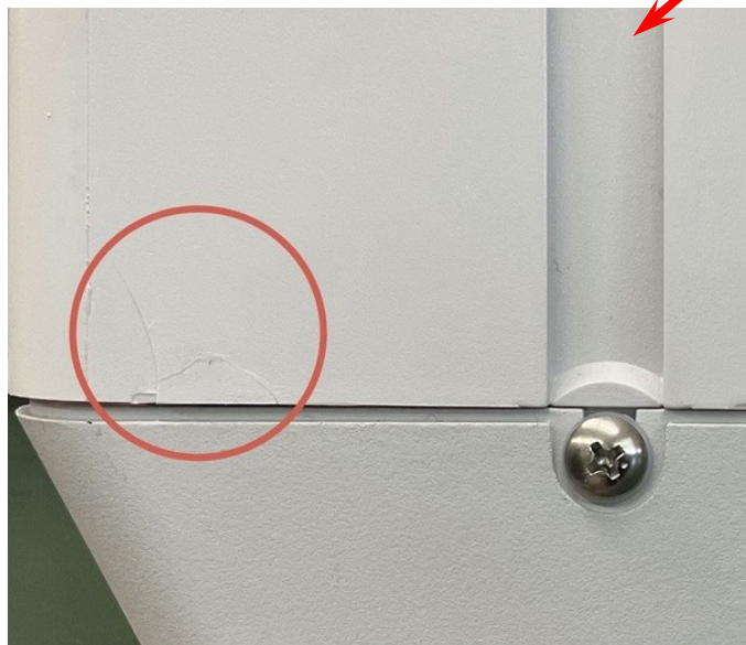
【微小ヒビ割れ部拡大】
